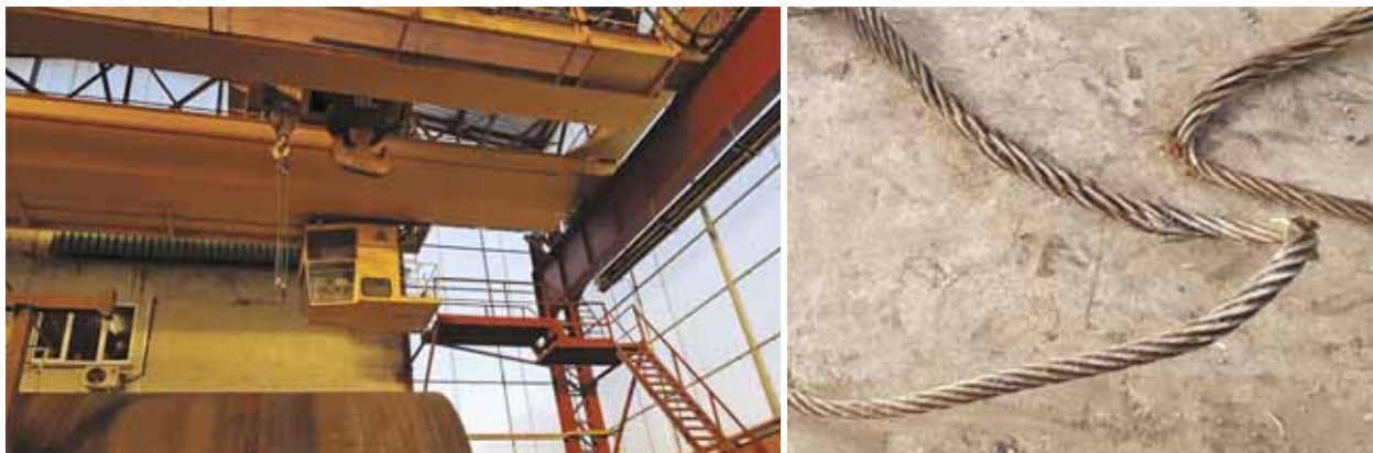
Рис. 32. Падение опорной площадки (толкатель) ограничителя подъема высоты крюка мостового крана в г. Ступино
