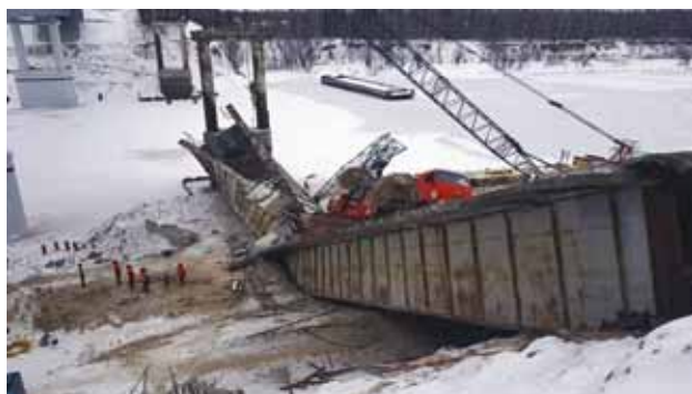
Рис. 56. Обрушение пролетного строения в ходе реконструкции моста через реку Юганская протока
