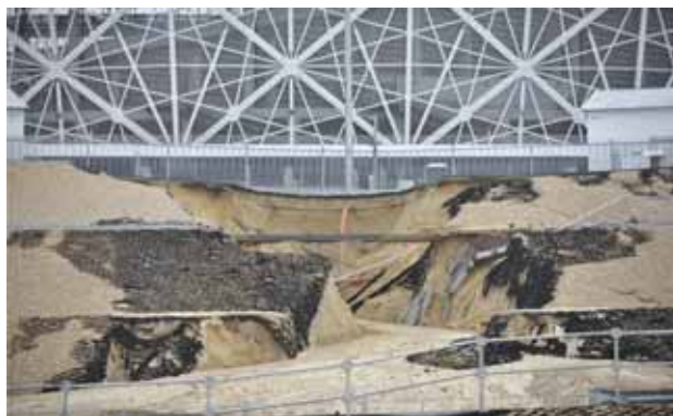
Рис. 55. Разрушение в ходе строительства стадиона в городе Волгограде после проливных дождей
