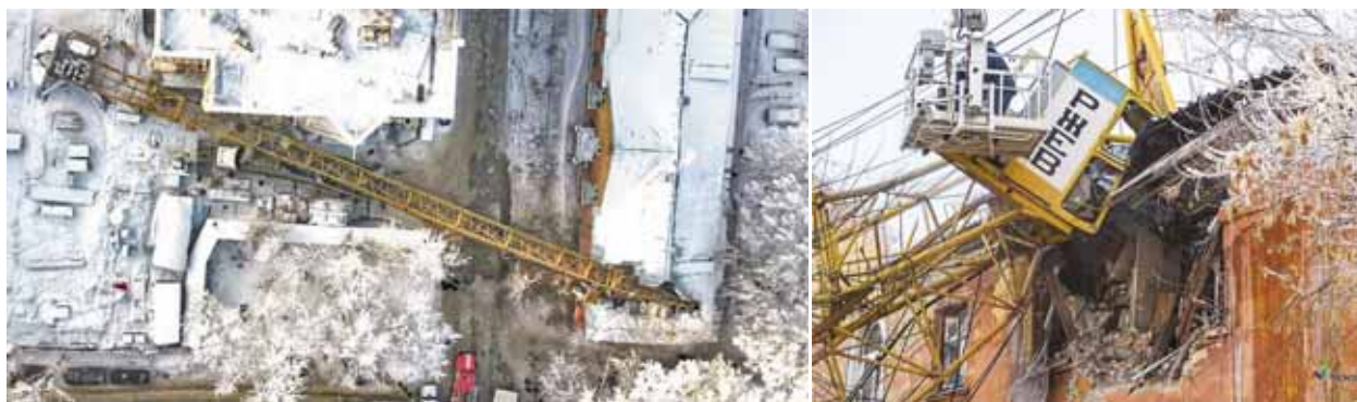
Рис. 30. Падение башенного крана на двухэтажный жилой дом в г. Кирове
