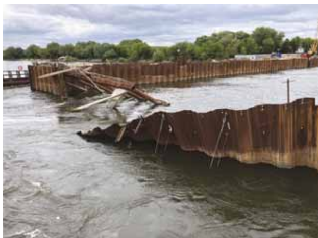
Рис. 54. Разрушение шпунтовой стенки котлована второй очереди в процессе реконструкции гидроузла Белоомут
