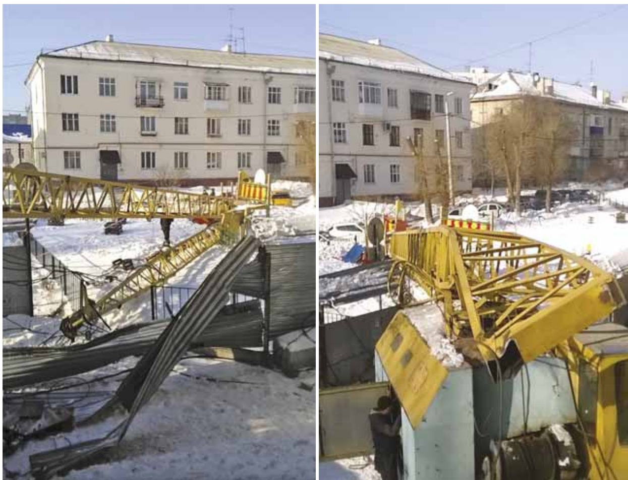
Рис. 31. Запрокидывание, падение и разрушение гусеничного крана на строительном объекте жилого дома в г. Тольятти
